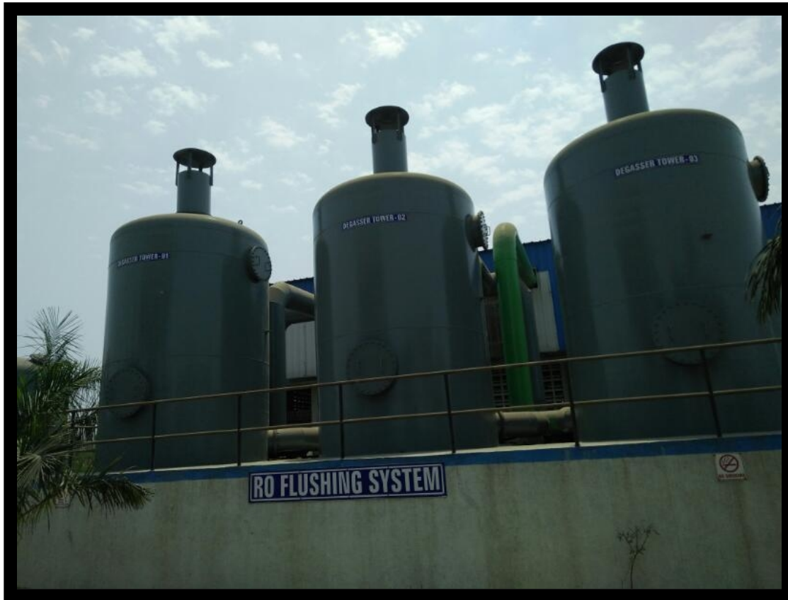
“Advance flushing treatment at TTP, Surat”
